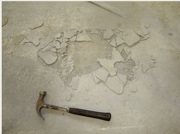
Bild 1. 1-2 mm tunt delaminerat skikt på hårdbetonggolvet med strömaterial.
